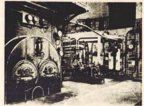
KESSEL III UND PUMPENANLAGE
